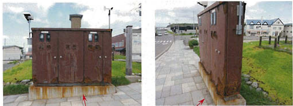
【塩害等により腐食が進行し、倒壊の危険のある分電盤】
