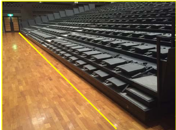
・構造体が歪み斜めに出ている状況
