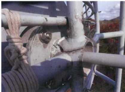
中央に亀裂・ロープで仮固定
