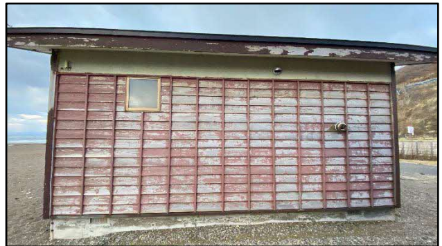
南側外壁・破風板現状
