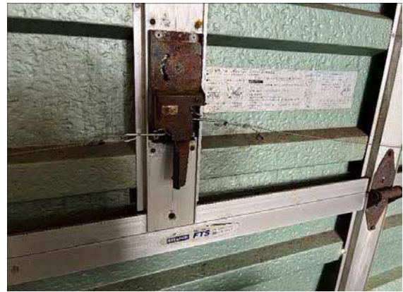
SSK錠の腐食状況
