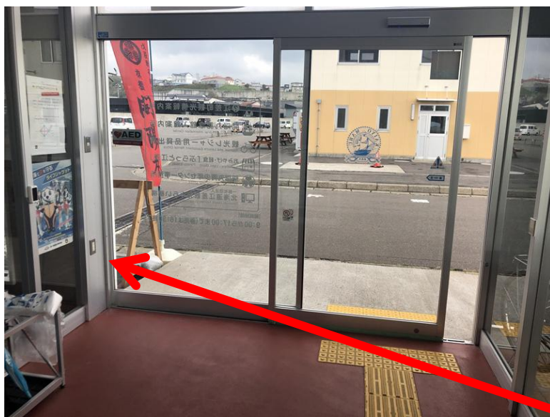
開陽丸青少年センター管理棟側のセンサー
