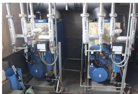
まるやまの重油ボイラー
