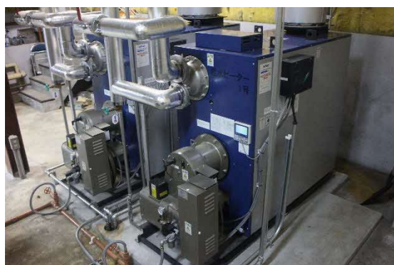
江差北小・中学校の重油ボイラー
