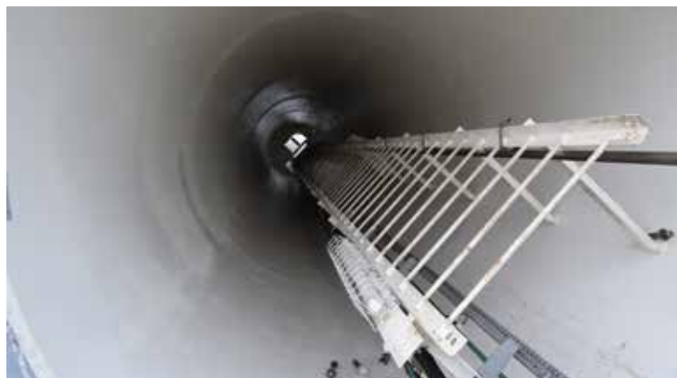
風力発電機の機内の写真。風車先端部まで梯子が設置されている。
