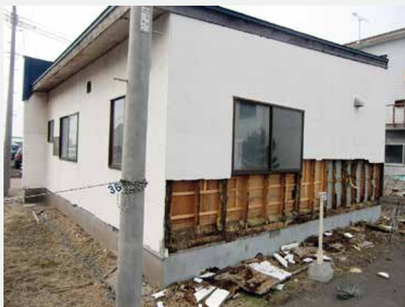
役場裏に建つ作業員詰所の壁が崩落
