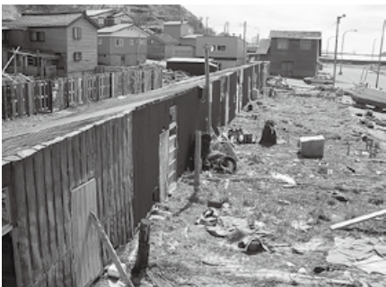
江差追分漁港(泊地区)の船揚場機械庫。数十年以上経過し、老朽化が進んでいる。庫内への雨水の流入や施設の倒壊で船揚用機器に損傷を与える恐れがあるため、機能向上を兼ねた早急な対応が必要となっている。
