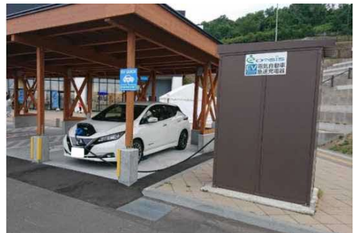
設置例：石狩 あいろーど厚田
