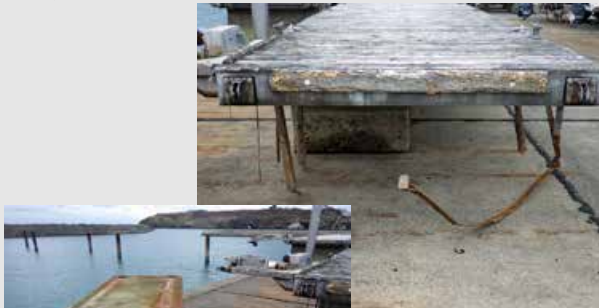
老朽化した浮棧橋
