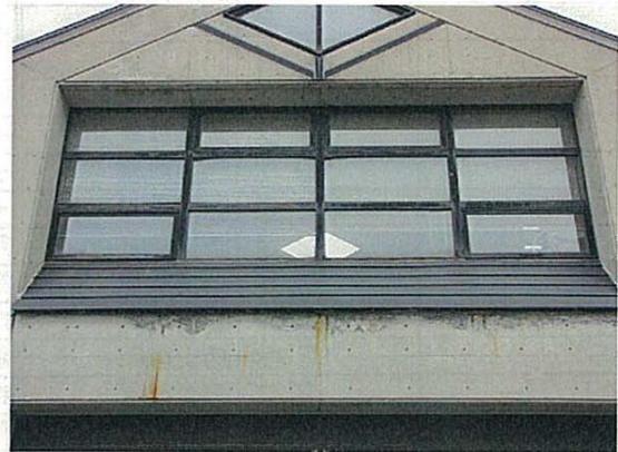
①消防団室外部の状況、開閉窓・排煙窓は腐食により開閉不能、複層ガラスは空気が注入し曇って
