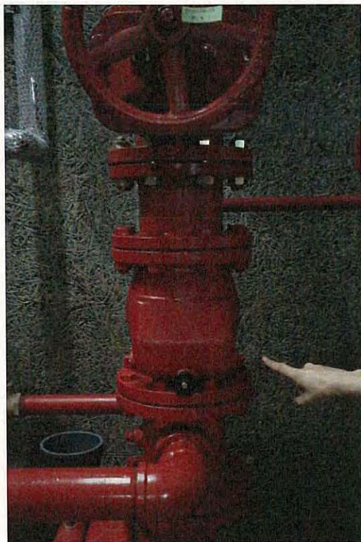
劣化した逆止弁の位置
