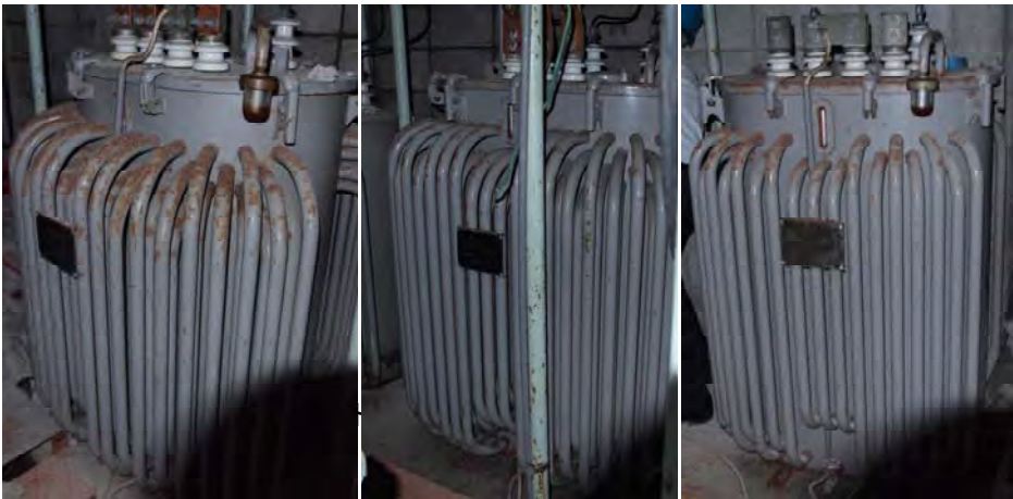
高圧トランス 3台
