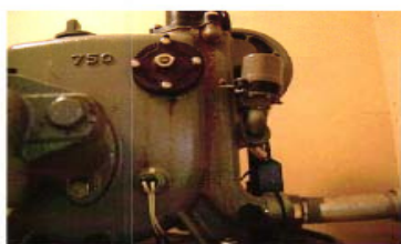
ポンプ拡大写真
