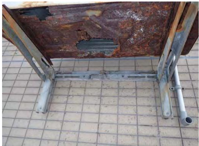
(底部腐食状況)
