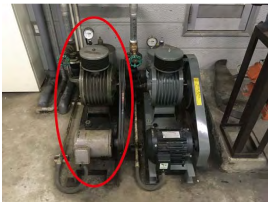
停止中の浄化槽ばっ気ブロワー（左側）
