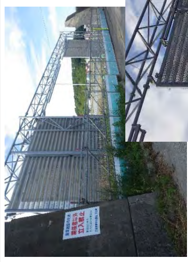
【東側侵入防止柵(使用者設置)と大型引戸扉の破損状況】
