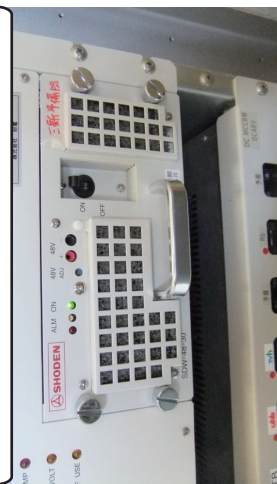
① バッテリー充電器電源ユニット
